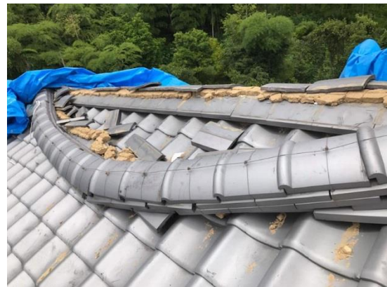
地震によりズレてしまった屋根瓦
