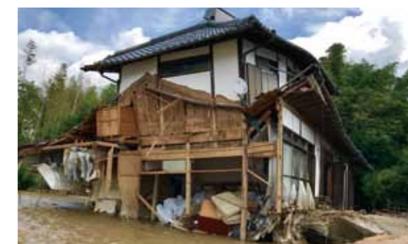
豪雨で被災した民家(福岡県朝倉市)
