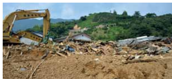
土砂崩れによって押しつぶされた家屋。
